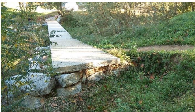
Figura 2 Extremo izquierdo del pasillo antes de la actuación, interrumpido por un boquete.
