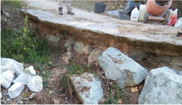
Figura 6 Camino descalzado antes de la actuación
