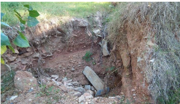
Figura 8 Zona erosionada antes de la actuación
