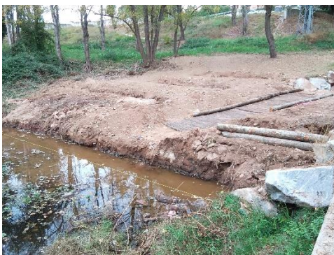
Figura 12 Margen derecho antes de la actuación
