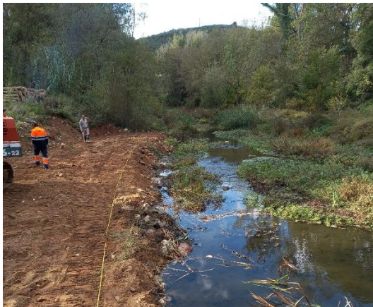
Figura 4 Margen izquierdo erosionado antes de la actuación.
