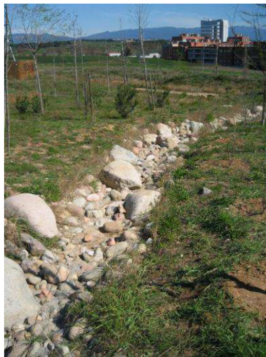
Parque dels Pinetons (Mollet del Vallés). Aliviadero de una balsa de riego que termina en una depresión para recargar el acuífero.
