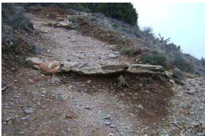
Imagen inicial de un drenaje con la parte frontal desestructurada en el camino de Coll d'Estenalles
