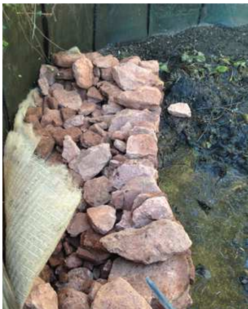
Construcción de una rampa de fauna con piedra con protecciones en la base y en el lateral para no afectar a la impermeabilización.
