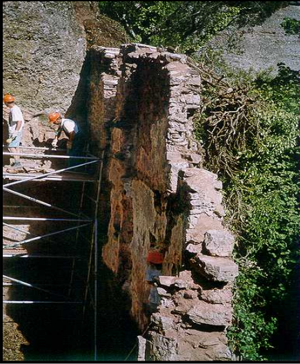
Restauración de un muro de piedra con mortero de cal y eliminación de la hiedra.
