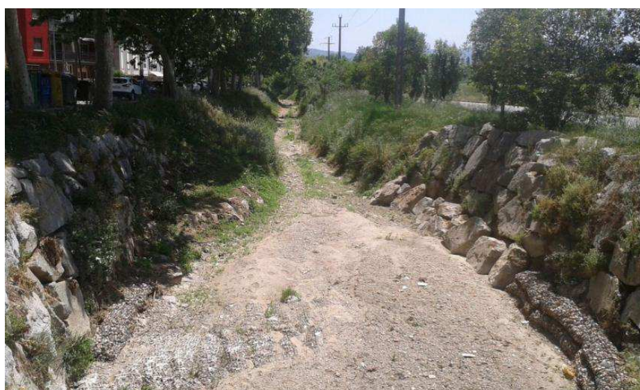
Imagen de la zona después de la ejecución y de lluvias. El lecho de gaviones ha quedado cubierto por los sedimentos.
