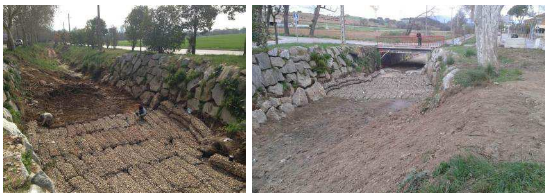
Entrega en los márgenes con la base de escollera, y atado de los gaviones entre ellos
