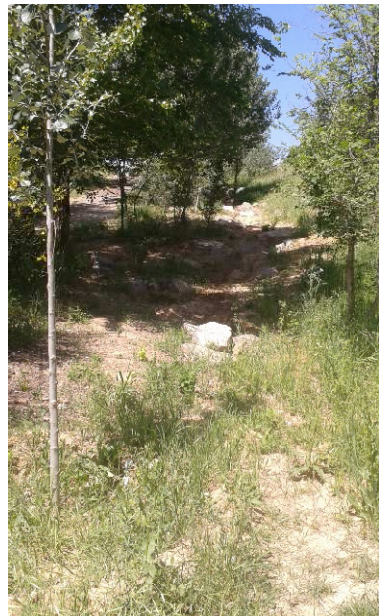
Drenatge al torrent de les Abelles. Rubí
