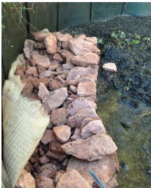
Procés de construcció d'una rampa de fauna amb pedra amb proteccions a la base i al lateral per no afectar la impermeabilització.
